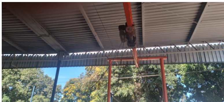
Imagem 9 – Pórtico de guincho elétrico de transporte. (Equip. 03)
