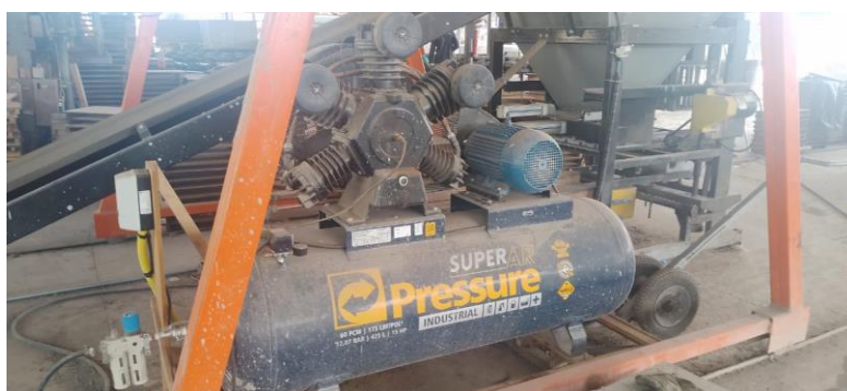
Imagem 24 – Compressor de ar. (Equip. 09)
