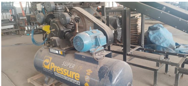
Imagem 28 – Compressor de ar. (Equip. 13)
