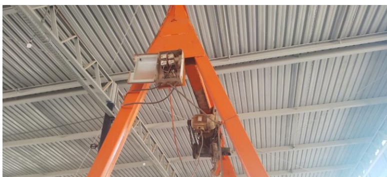
Imagem 17 - Pórtico: Guincho elétrico e quadro de comando (Equip. 02)
