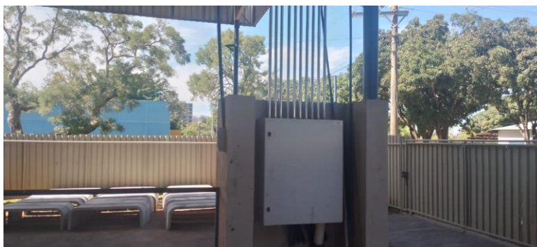
Imagem 29 – Parte elétrica da NUPAC.
