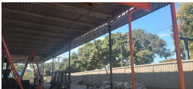
Imagem 12 – Vista estrutural da fábrica e outro pórtico de guincho elétrico. (Equip. 04 e 05)
