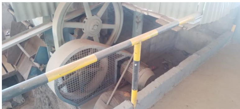
Imagem 3 – Motor da betoneira industrial. (Equip. 01)
